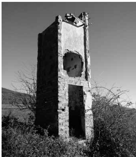
Estado actual de la caseta transformador de Marcelino Otero, en la Chana de las Traviesas. Foto JAY
